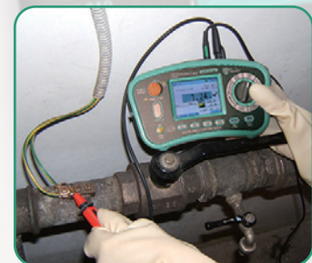
การตรวจสอบความต่อเนื่องของ การประสานสัณยัไฟฟ้าเท่า
